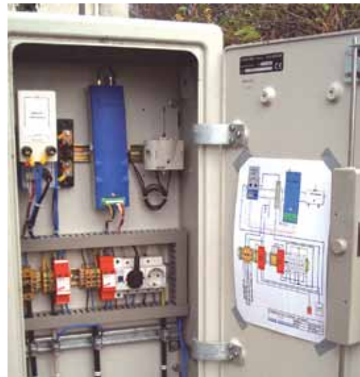
Ferngesteuerte Schutzanlagentaktung mit Netzteil innerhalb des Schutzstromgerätes
