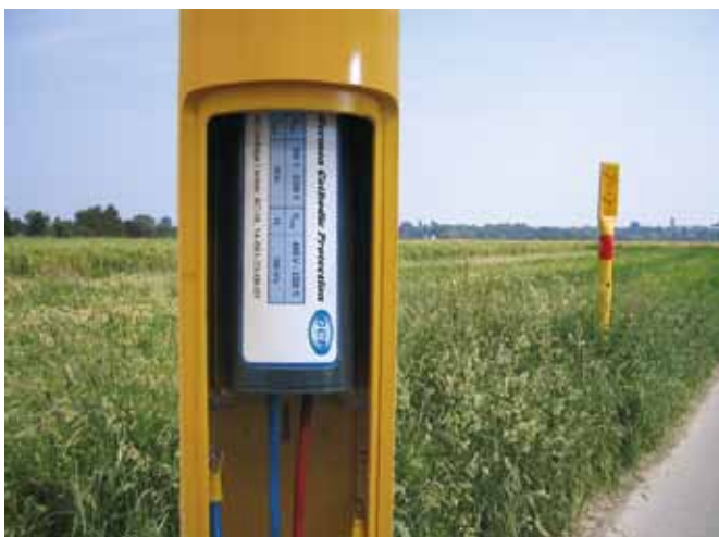
AC-Abgrenzeinheit VL-14-401, eingebaut in einer Schilderpfahl-Meßstelle
