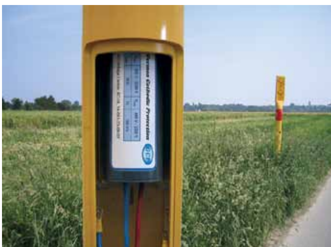
AC-Abgrenzeinheit VL-14-401, eingebaut in einer Schilderpfahl-Meßstelle
